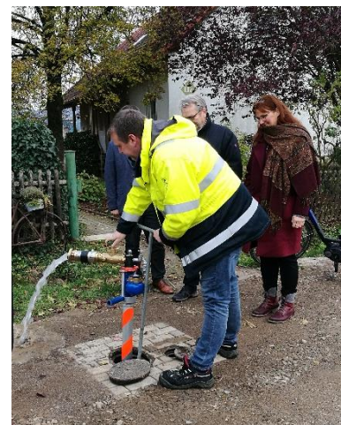
Abb. 10: 15. Nov. 2019, Einweihung der neuen Wasserversorgung über HarzEnergie von der Sösetalsperre.
